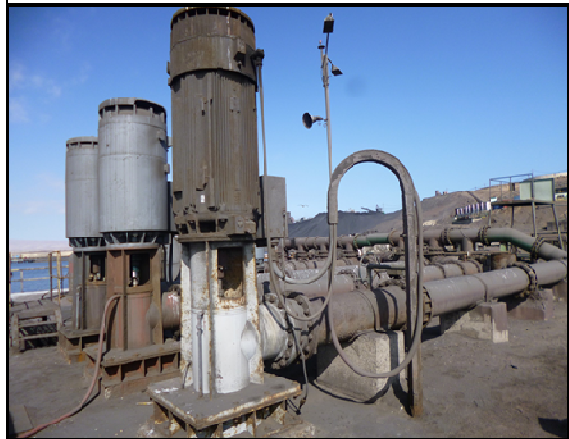
Foto N° 9. Tres de las electrobombas ubicadas frente al mar, para la captación de agua de enfriamiento, utilizada en el condensador.
