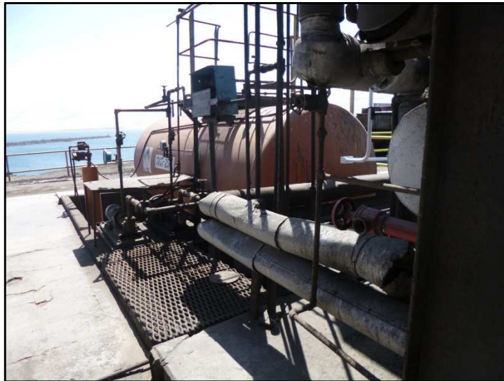
Foto N° 5. La vista muestra al tanque de almacenamiento de diesel DB5, desde otro ángulo. El tanque se encuentra dentro de una poza de estanca o de contención para casos de derrames.
