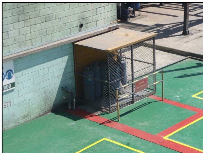
Foto N° 6. Cilindros de propano cerca al área de almacenamiento de combustibles. Se observa que los cilindros de gas propano se encuentran debidamente sujetos con cadenas, dentro de una celda aislada y adecuadamente aireada.
