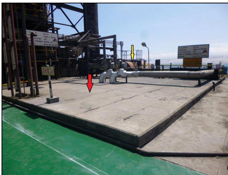
Foto N° 4. Área de almacenamiento de combustibles, ubicado en los exteriores del edificio de la Central Térmica. La vista muestra señalada con flecha roja la plataforma de concreto que constituye el techo de las estructuras de concreto que contienen los tres tanques de petróleo residual R-500. Al fondo señalado con flecha color amarilla se indica la ubicación del tanque de diesel DB5.
