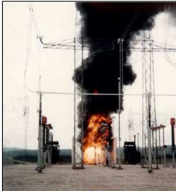
Foto N° 11. Foto que muestra un incendio luego de una explosión en un transformador
