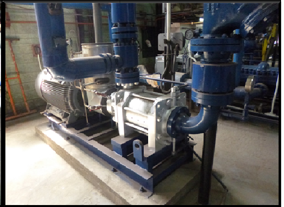
Foto N° 8. Una de las electrobombas más moderna de carga de agua a los calderos
