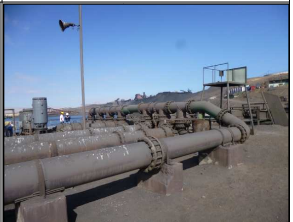
Foto N° 10. Al lado izquierdo de la foto, se observan otras tres electrobombas de bombeo de agua de mar hacia la Central Térmica para su uso como enfriamiento.
